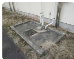
インフラ施設（屋外水柱）
